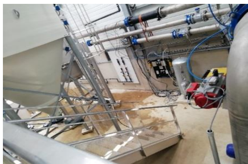
Station traitement des pesticides et décarbonatation BS1
