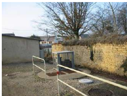
Poste de relèvement école à COMBERTAULT
