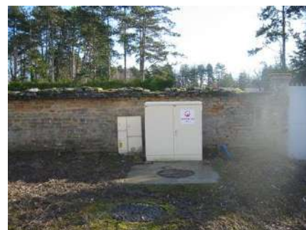
Poste de relèvement rue aux loups
