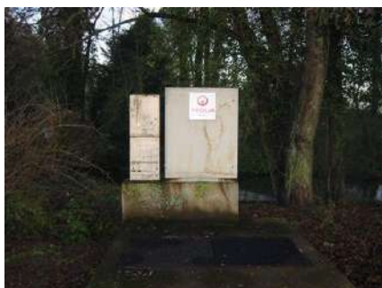
Poste de relèvement Bouzaize
