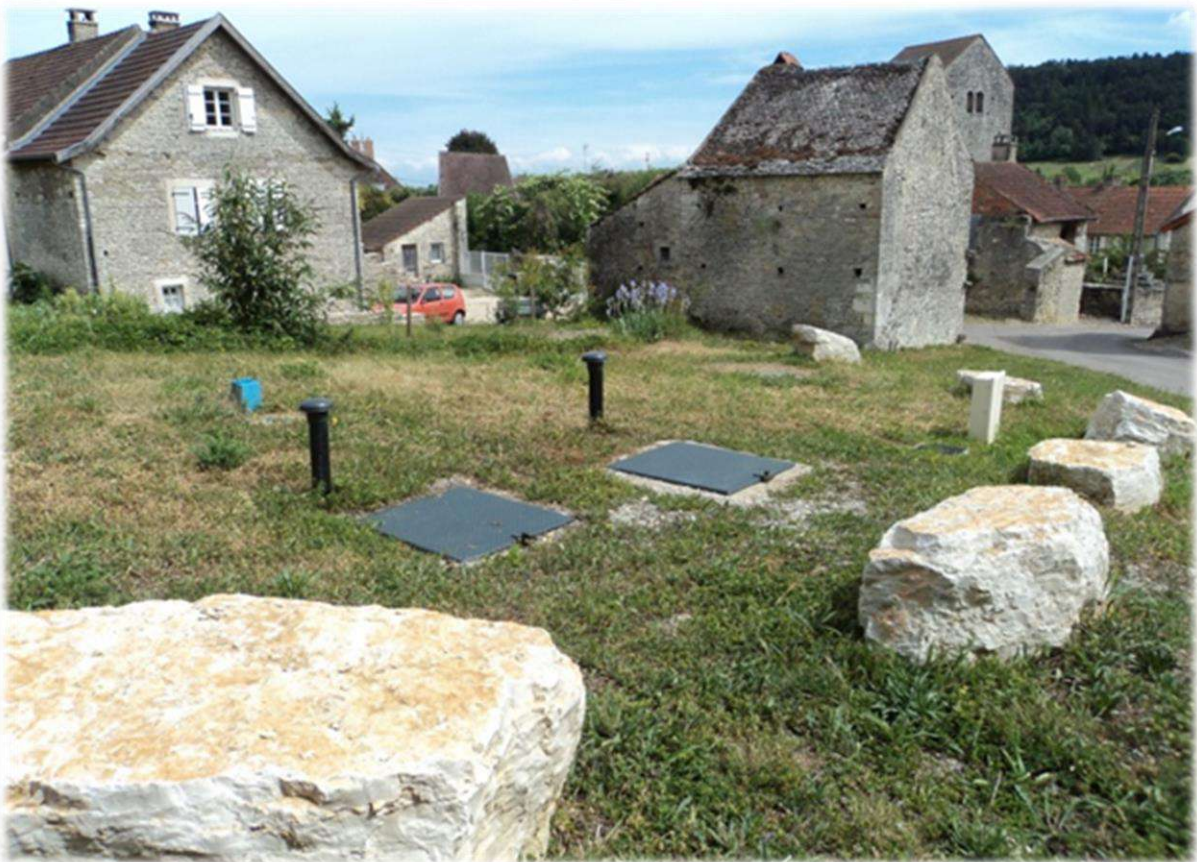
Auxey-Duresses : système de désinfection eau potable
