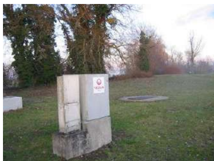
Poste de relèvement du Golf
