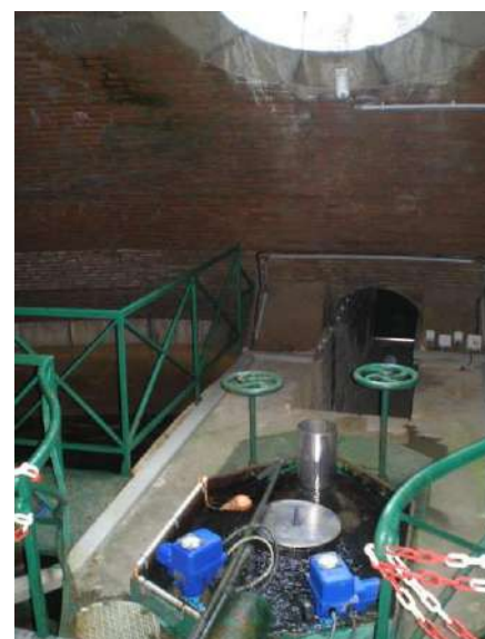
Equipements à l'intérieur du réservoir
