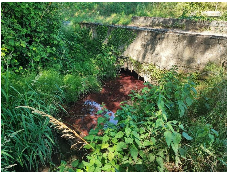
Hydrocarbures sortant du réseau des Eaux pluviales avant intervention.
