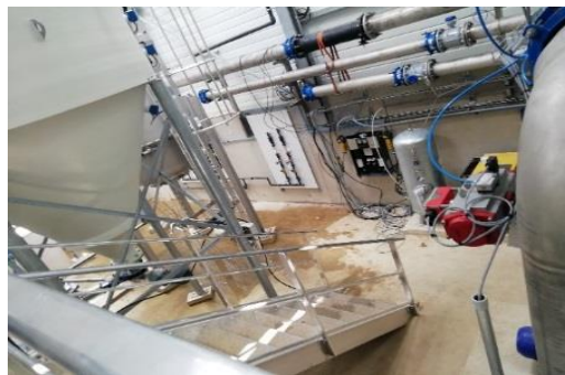
Station traitement des pesticides et décarbonatation BS1
