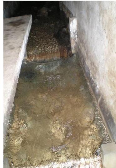
Arrivée des eaux dans le captage du Petit et Grand Champy
